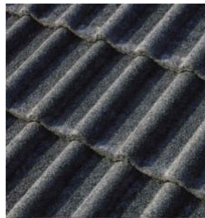
Tegole in cemento - criticità
